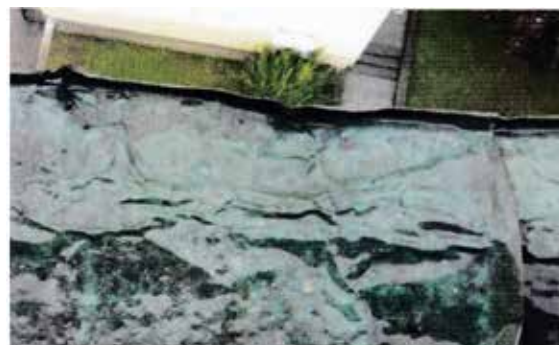
Fotos von den Schäden im Kirchturm
