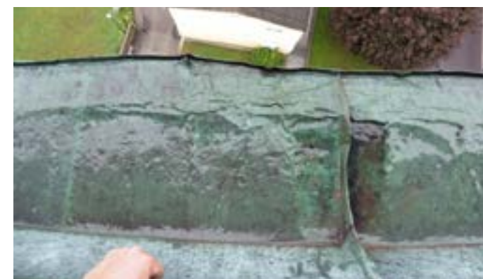
Kupfereindeckung - Risse und Faltenbildung
